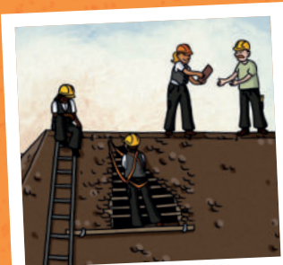
Das Team des Dachdeckerbetriebes „Gute Aussicht“ repariert das Dach in luftigen Höhen.
